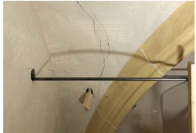
Risse im Gewölbe | Cracks in the vault
