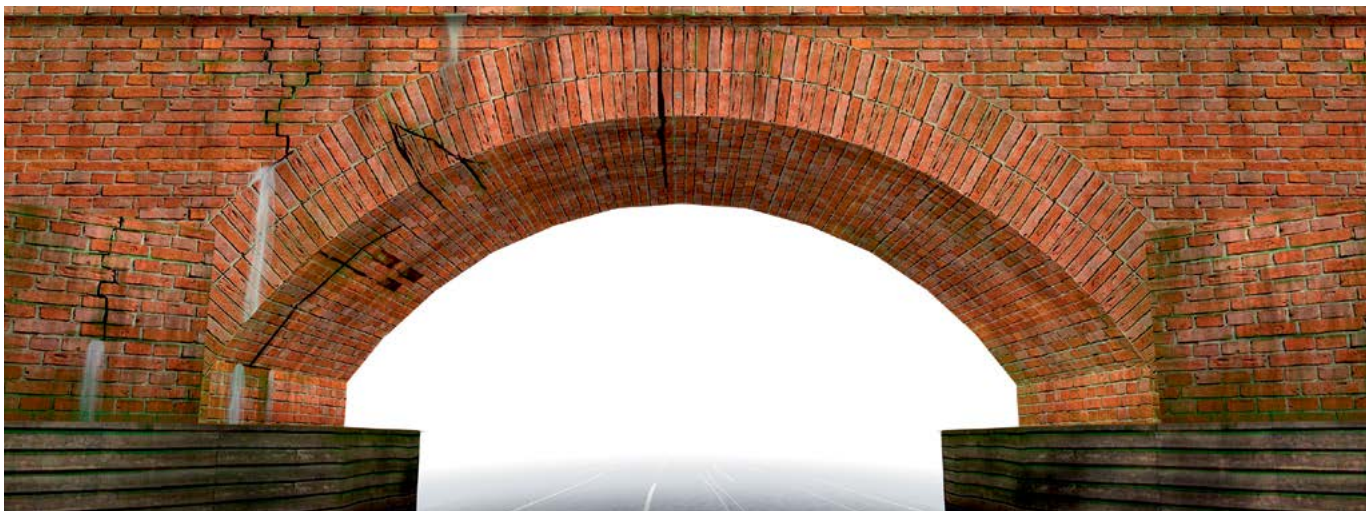
Risse im homogenen Mauerwerk - Sanierung mit mineralischen Füllstoffen | Cracks in homogeneous masonry - restoration with mineral filling materials
