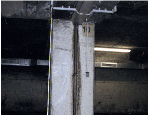
Raumfuge im Unterzug mit Auffangkonstruktion, defekte Entwässerung
