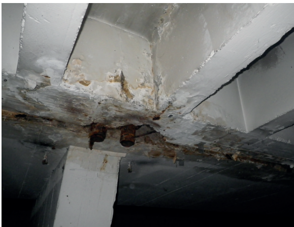
Raumfuge im Unterzug mit Wasserdurchtritt, Betonschäden
