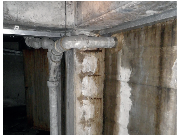
Raumfuge mit Wasserdurchtritt im Wandanschluss an Unterzug und Stütze
