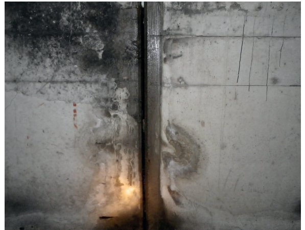
Raumfuge Außenwand mit Wasserdurchtritt
