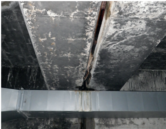
Raumfuge im Unterzug mit Wasserdurchtritt, teilweise bauzeitliche Holzwerkstoffplatten als Fugeneinlagen
