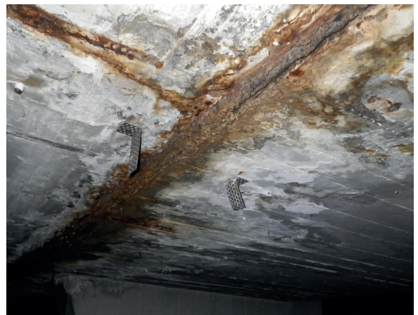
Raumfuge im Unterzug mit Wasserdurchtritt, Betonschäden
